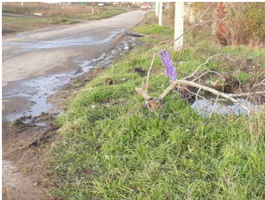
Фигура 3: Преливане на отпадъчни води от канализация (в село близо до Кишинев)
