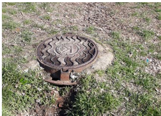
Figura 6. Capacul unei fose septice a unui sistem local de canalizare pentru ape gri de la o școală dintr-o localitate rurală. Țevile pentru ape gri se termină într-o râpă, astfel apele reziduale fiind transportate în râu cu apele pluviale. O fotografie dintr-un sat din sudul Moldovei.
